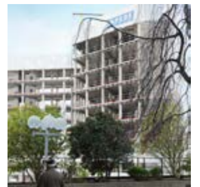
Tour Ampère à La Défense (92). Dépose et désamiantage de 2 km d'enveloppe de calorifuge, 85 traversées fibrociment et 70 ml de bitume sur tuyauterie : VINCI Construction France prend en charge le curage, le désamiantage et le démantèlement des façades de l'immeuble afin d'en faire une vitrine de bâtiment écologique à fin 2016.
