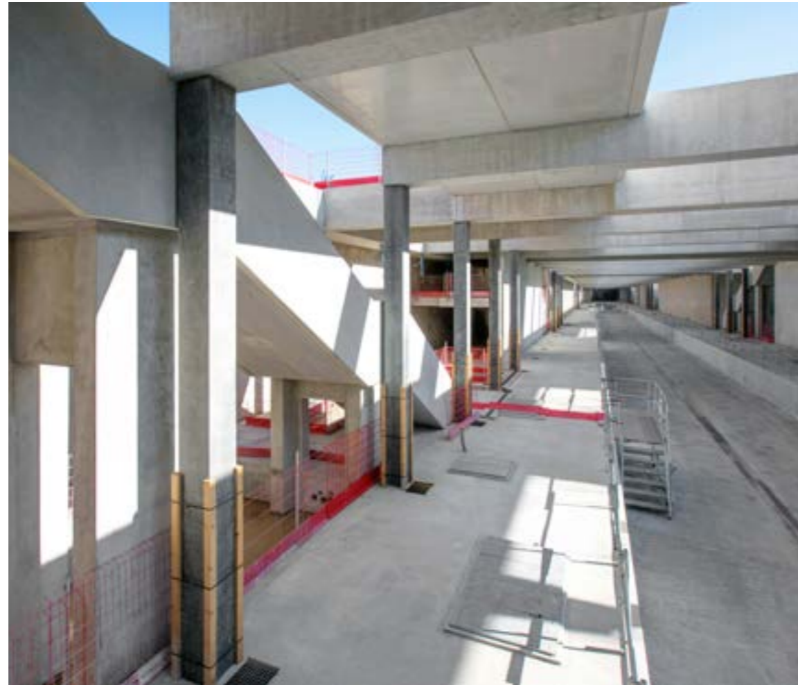
Le projet CEVA (Cornavin - Eaux-Vives - Annemasse), un "RER" transfrontalier franco-suisse, assurera la liaison ferroviaire cadencée entre la gare d'Annemasse (74) et celle de Cornavin à Genève (Suisse). Le tronçon français de 1,5 km, réalisé par VINCI Construction France, comprend notamment une tranchée couverte de 900 m, avec une trémie d'accès de 650 m, ainsi qu'un pont-route et une passerelle. Il vient compléter les quatre lots réalisés côté Suisse, à Carouge et entre la halte des Eaux-Vives et la halte de Chêne-Bourg, avec plus de 3,5 km de tranchée couverte.
