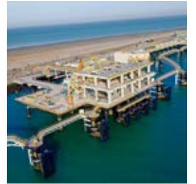
Terminal méthanier à Dunkerque (59). VINCI Construction France réalise cette infrastructure géante de regazéification de gaz naturel liquéfié (GNL), qui aura une capacité d'accueil annuelle de 13 Gm 3 de gaz.
