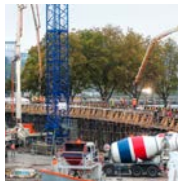
À Boulogne-Billancourt (92), VINCI Construction France a pris en charge la réfection du pont Dayd et la construction d'une rampe d'accès à cette structure métallique de 143 ml de long franchissant le grand bras de la Seine et la RD1.
